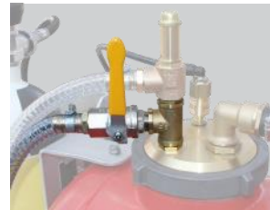
Druckentlastung über eine Entlastungsleitung
