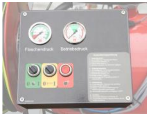
Armaturenkasten ohne elektrischer Füllstandsanzeige
